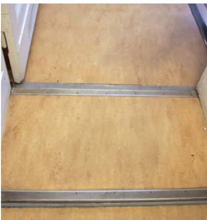
Höhenunterschiede im Fußboden sollten farbig kontrastreich markiert werden.
